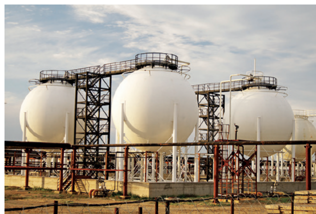
Figura 1. Almacenamiento de gas natural licuado a presión atmosférica y temperatura -161^{\circ}\text{C} . En su interior no hay aire no es de aplicación el Real Decreto 681/2003.
