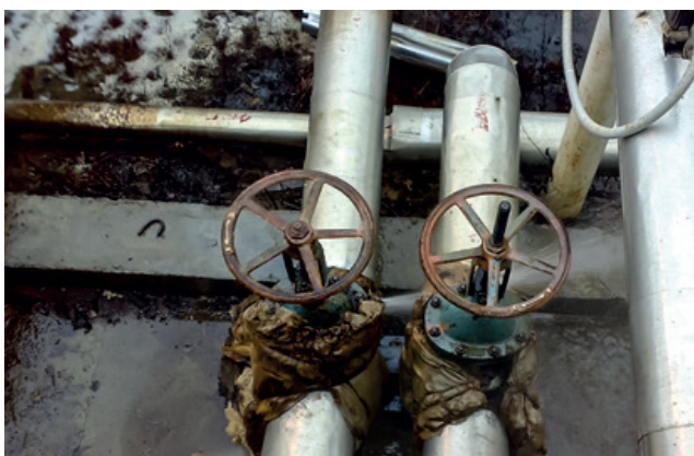
Figura 17. Fallos en bridas, válvulas y elementos de unión.
