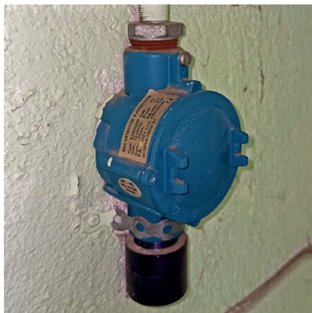
Figura 20. Detector de gas.
